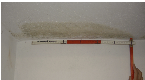
Abb. 15: Einer der Schimmelflecken des Neuschadens
