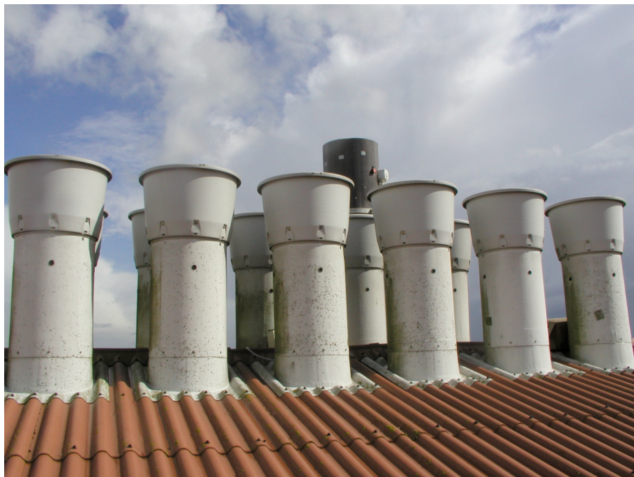
Abb. 2.3: Emissionsquelle des zwangsbelüfteten Stalles B. Ein Abluftschacht ist mit einem Aufsatz (Messschacht) zur Probennahme bestückt.
