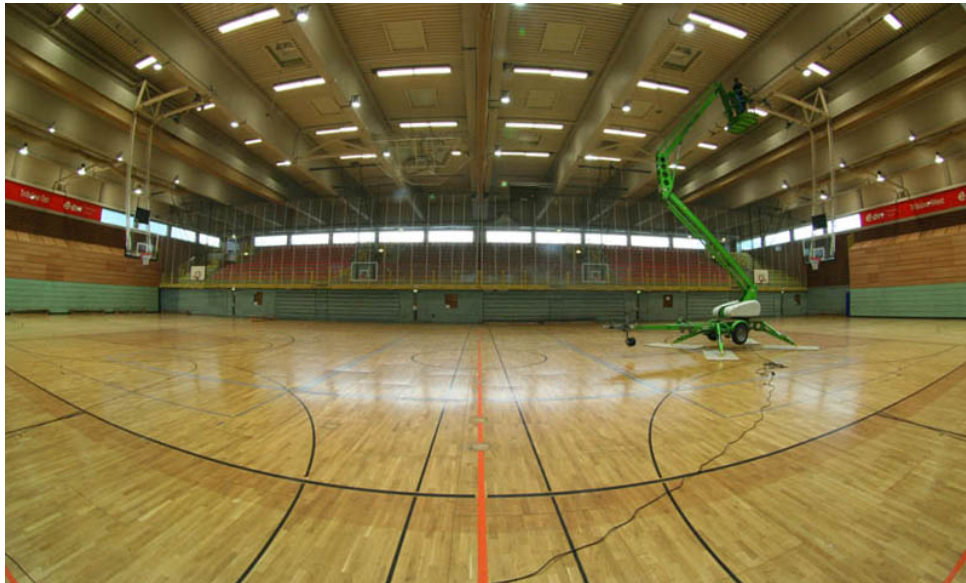
Abbildung 6.2: Installation des Video-Systems in der Masperrnhalle in Paderborn
