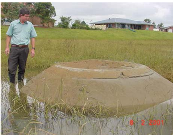
Abb. 7: Extremer Feinkornaustrag („Vulkan“) infolge Dammunterströmung (Foto L. Nagy). Sollte bereits im Anfangsstadium durch Auflage eines filterstabilen Geotextils und Auflastschüttung verhindert werden.
