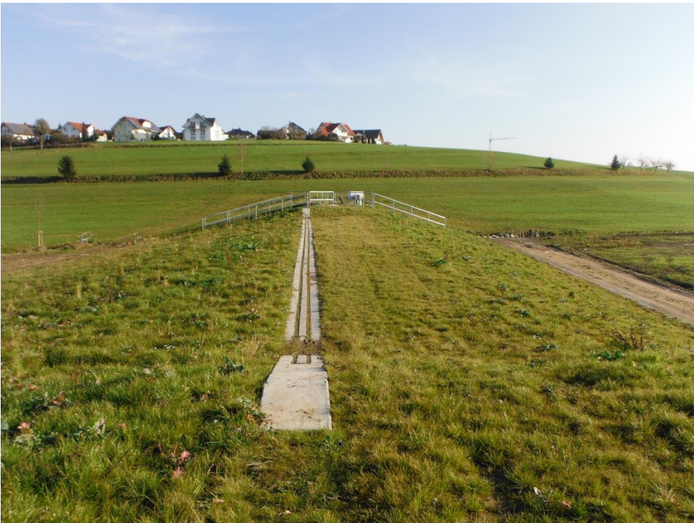
Abb. 9: Der Dammkörper ist fertiggestellt. Im luftseitigen Kronenbereich wurde eine nachjustierbare Überlaufschwelle integriert.
