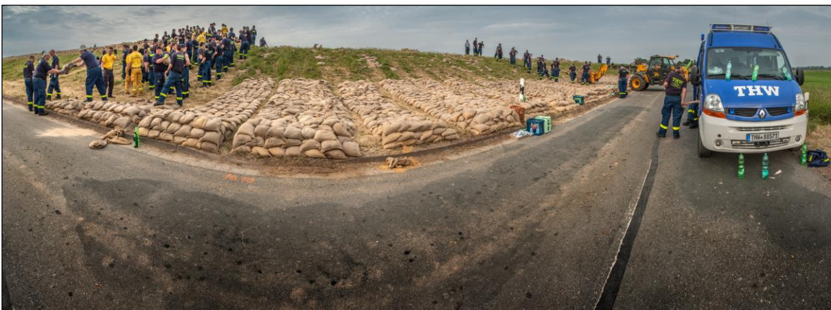
Abb. 1: Bau eines Auflastfilters aus Sandsäcken zur Sicherung der Binnenböschung des Elbedeichs bei Hitzacker im Juni 2013
