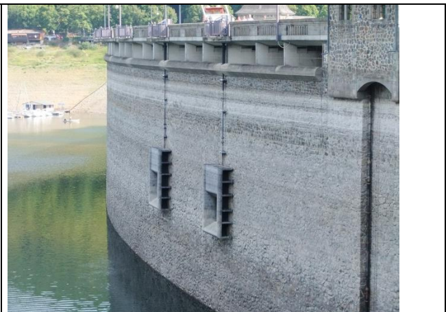
Abb. 2: Edertalsperre Einläufe Zwischenauslässe (Foto: HAUFE)
