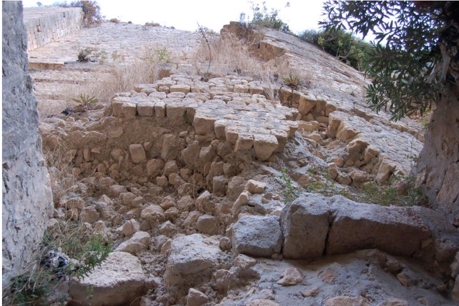
Abb. 14: Unterer Teil des stark beschädigten Mauerbogens.
