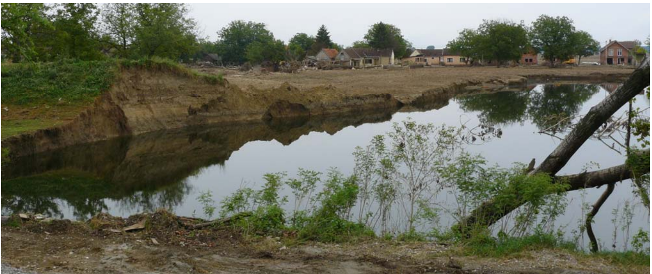
Abb. 18: Dambruch mit landseitig weitreichender Auskolkung des Untergrundes.
