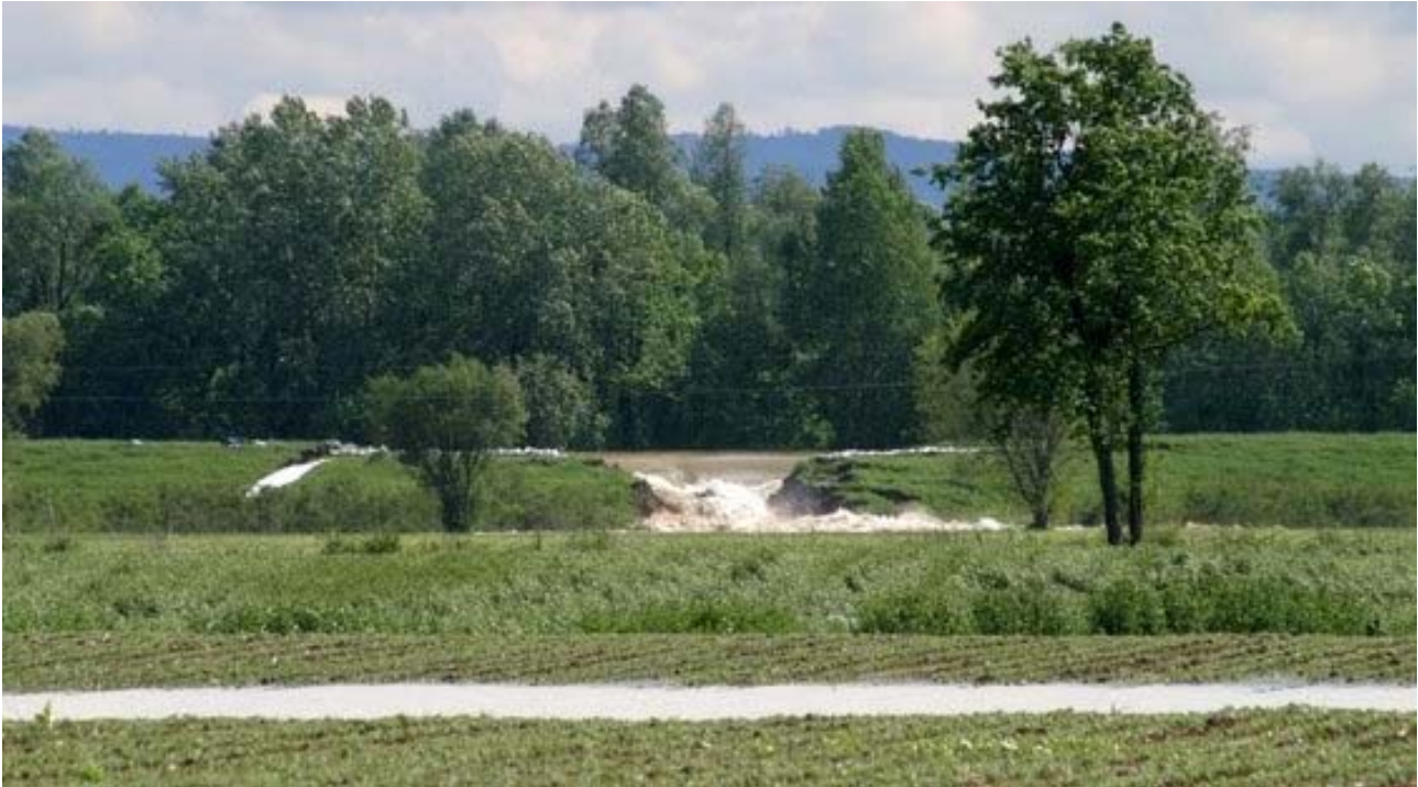
Abb. 19: Anfangsphase eines weiteren Versagens des Save-Dammes flussabwärts der großen Bruchstelle in Rajevo Selo (Kroatien).
