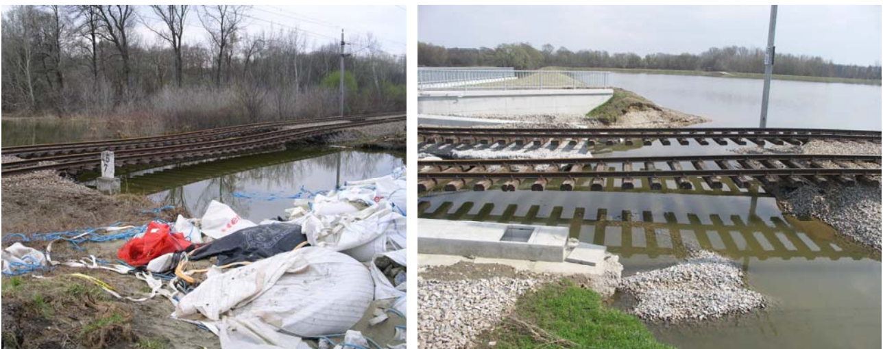
Abb. 5: Nach Dammbruch an der March (2006) infolge innerer Erosion eingeleitete Ausspülung des zum Hochwasserschutzdamm parallel verlaufenden Bahndammes (Fotos: G. Frei, S. Blovsky, 2006). Dauer der Flut: 36 Tage; max. HQ 200
