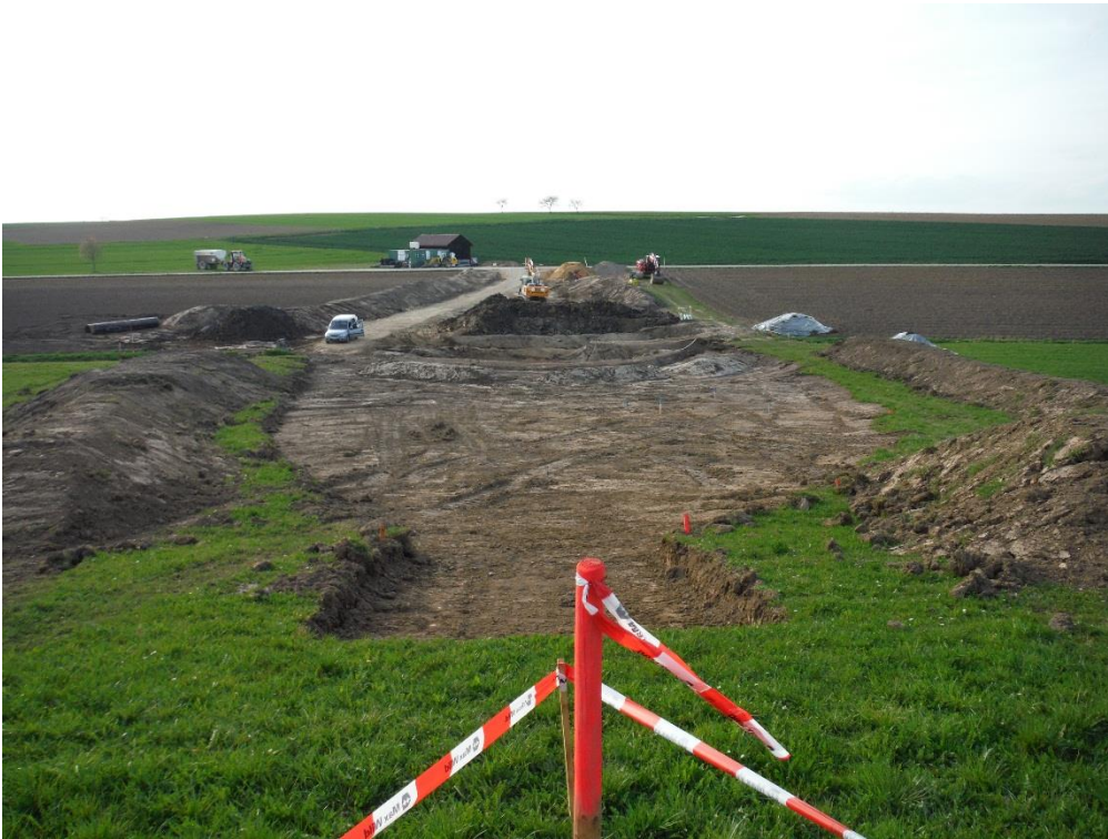
Abb. 7: Die Dammaufstandsfläche ist freigelegt und vorbereitet für das Einfräsen von hydraulischem Mischbindemittel.
