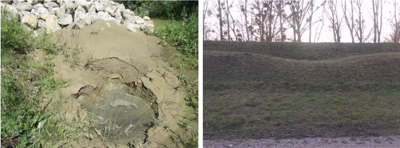
Abb. 21: Feinsandausspülungen am landseitigen Böschungsfuß (links: Foto S. Blovsky 2016) und Setzungsmulde im Altdamm aufgrund von Untergrunderosionen.
