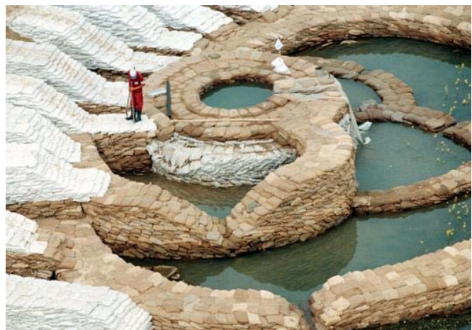
Abb. 8: Sofortmaßnahmen am landseitigen Dammfuß durch Errichtung von Sandsackbecken um die Aufbruchstelle zwecks Reduktion des hydraulischen Gradienten (Foto L. Nagy).
