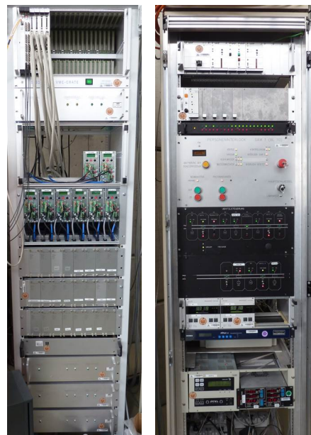
(a) Motorrack (b) Steuerrack PSS und VCS
