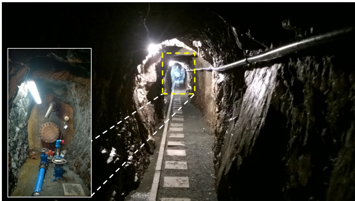
Abbildung 59: Bild des Wasserentnahmebereichs des Trinkwasserführenden Stollens in Mudersbach-Birken
