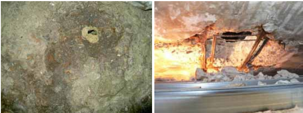
Abbildung 3-176 - Loch in der Geschossdecke (Oberseite)
