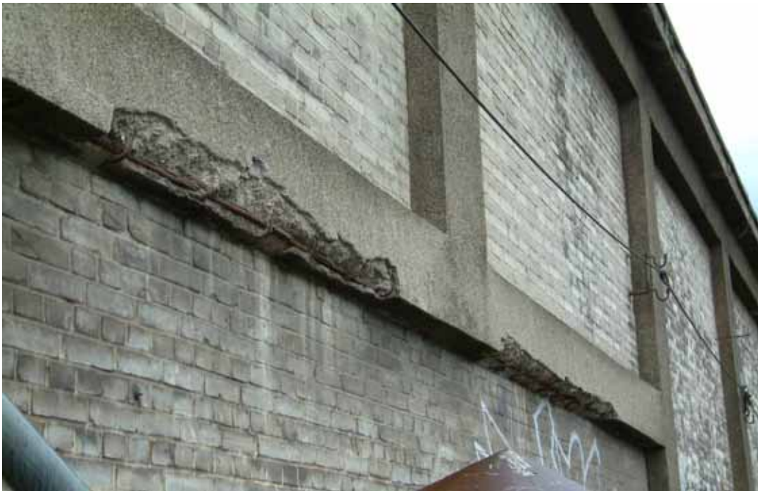
Abbildung 3-121 -Freiliegende korrodierte Bewehrung an der "Mechanischen Werkstatt" der Charlottenhütte, Niederschelden
