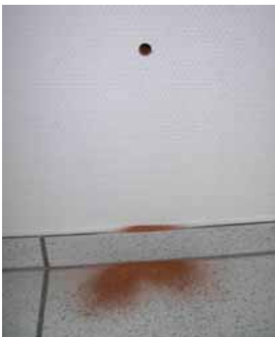
Abbildung 3-175 - Das Bohrmehl identifiziert die Auflager der Unterzüge der Decke über EG eindeutig als Mauerwerkspfeiler
