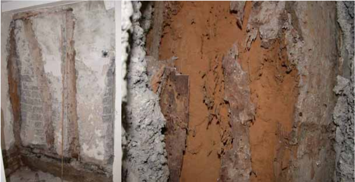
Abbildung 3-256 - Freilegen der Wandkonstruktion Abbildung 3-257 - Pilz- und Insektenschäden
