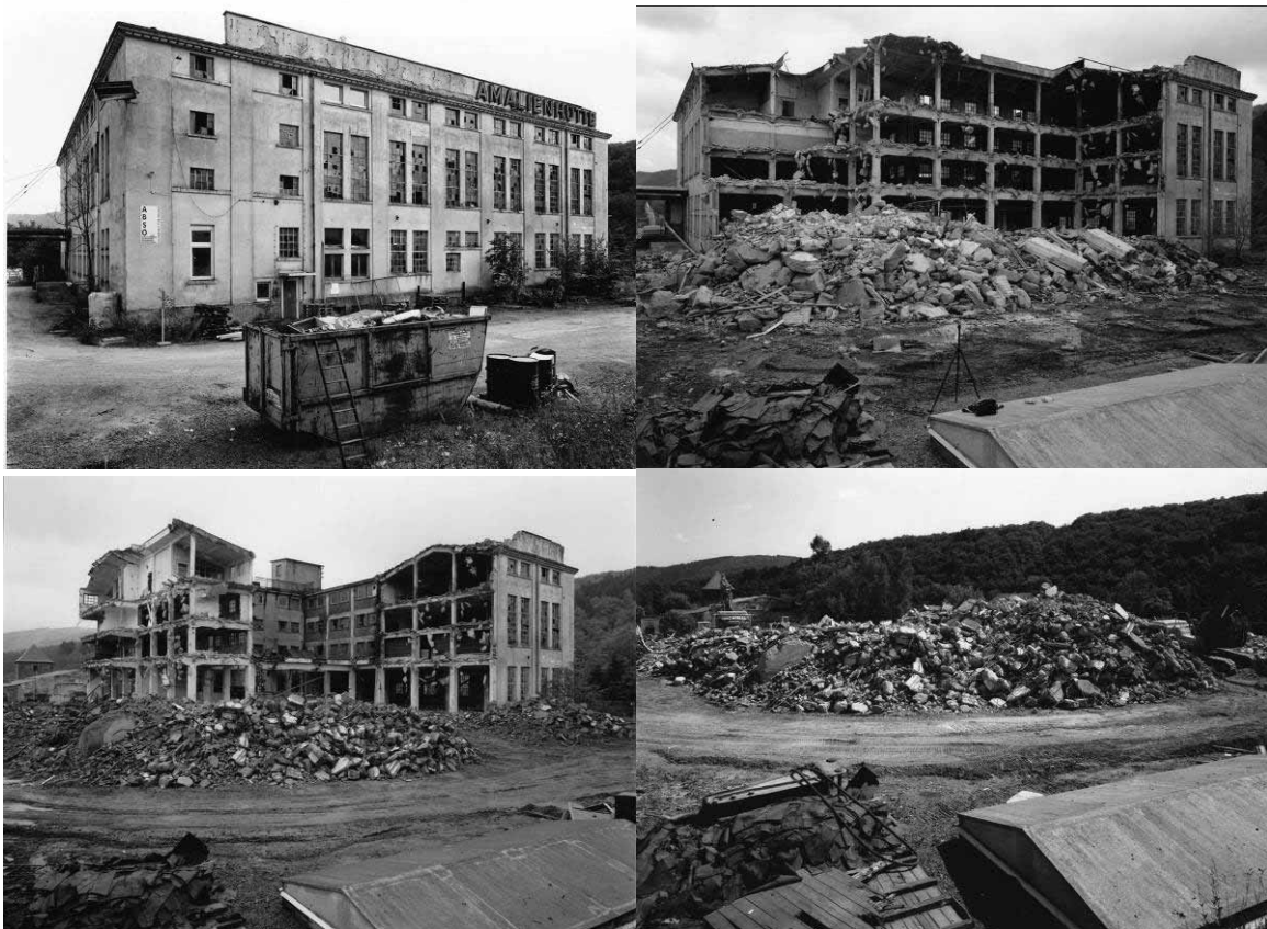
Abbildung 4-106 - Bildfolge Abbruch der "Neuen Schlosserei" der Amalienhütte, Bad Laasphe (Q.: H. Sehak)
