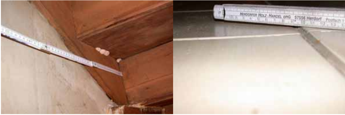
Abbildung 3-250 - Befall unter der Treppe
