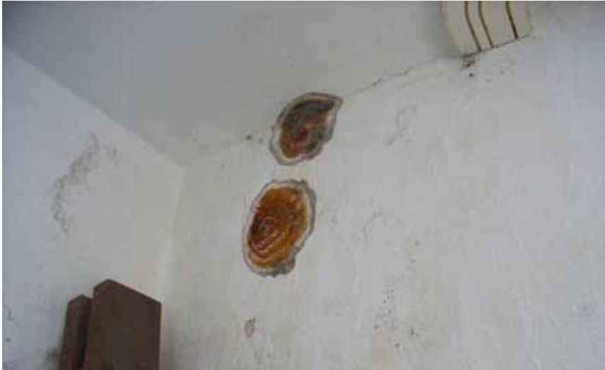
Abbildung 3-107 - Durch Mauerwerk gewachsener Fruchtkörper des Echten Hausschwammes
