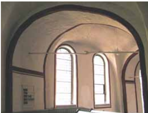
Abbildung 5-53 - Zugband eines Bogens in der Nikolaikirche, Siegen
