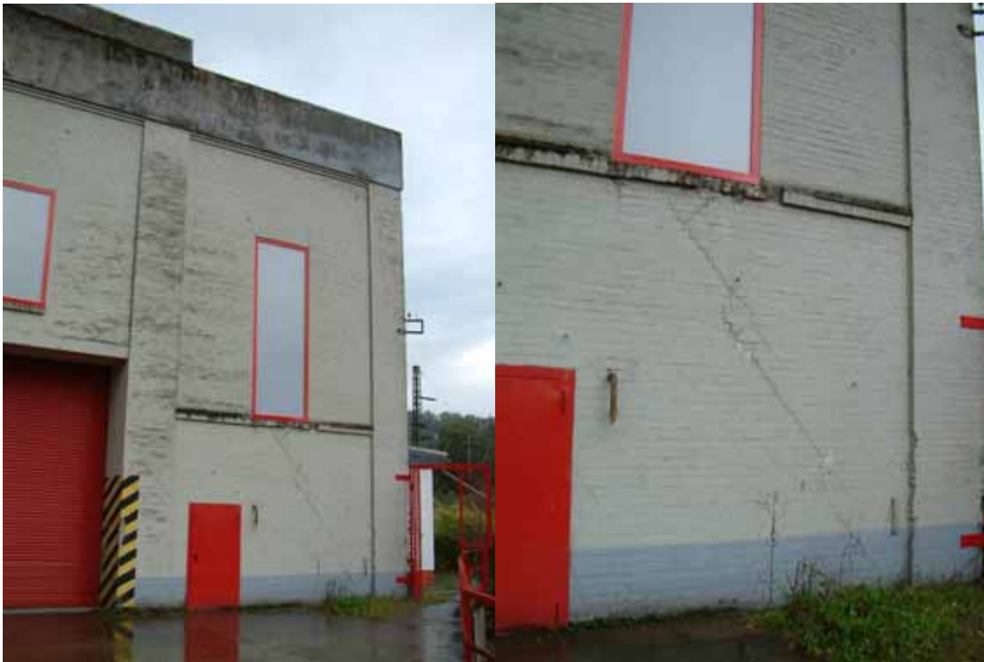
Abbildung 3-119 - Setzungsrisse im Mauerwerk der... Abbildung 3-120 - ... auf verschiedenen Böden (Flussbett) gegründeten "Mechanischen Werkstatt" der Charlottenhütte, Niederschelden
