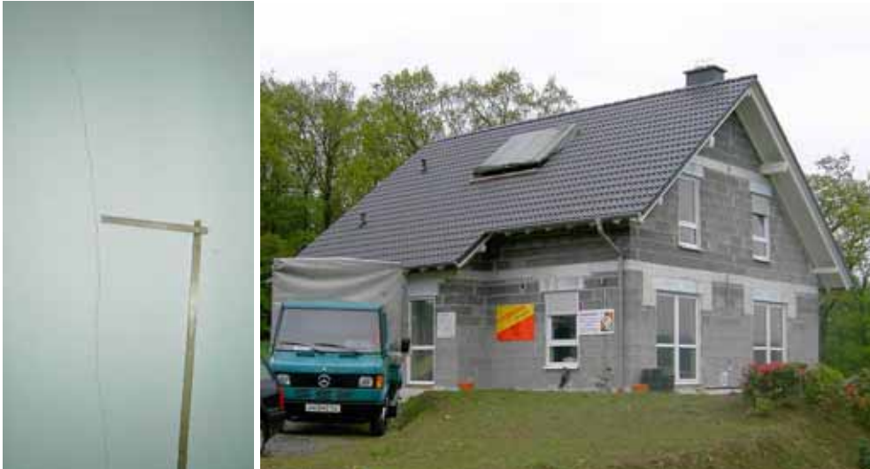
Abbildung 3-115 - Von Decke bis Fußboden durchgehender Riss... Abbildung 3-116 - ...in der parallel zum First verlaufenden Mittelwand (in allen Geschossen)
