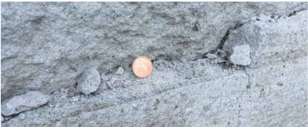
Abbildung 4-8 - Risse im Sockel einer Kirche
