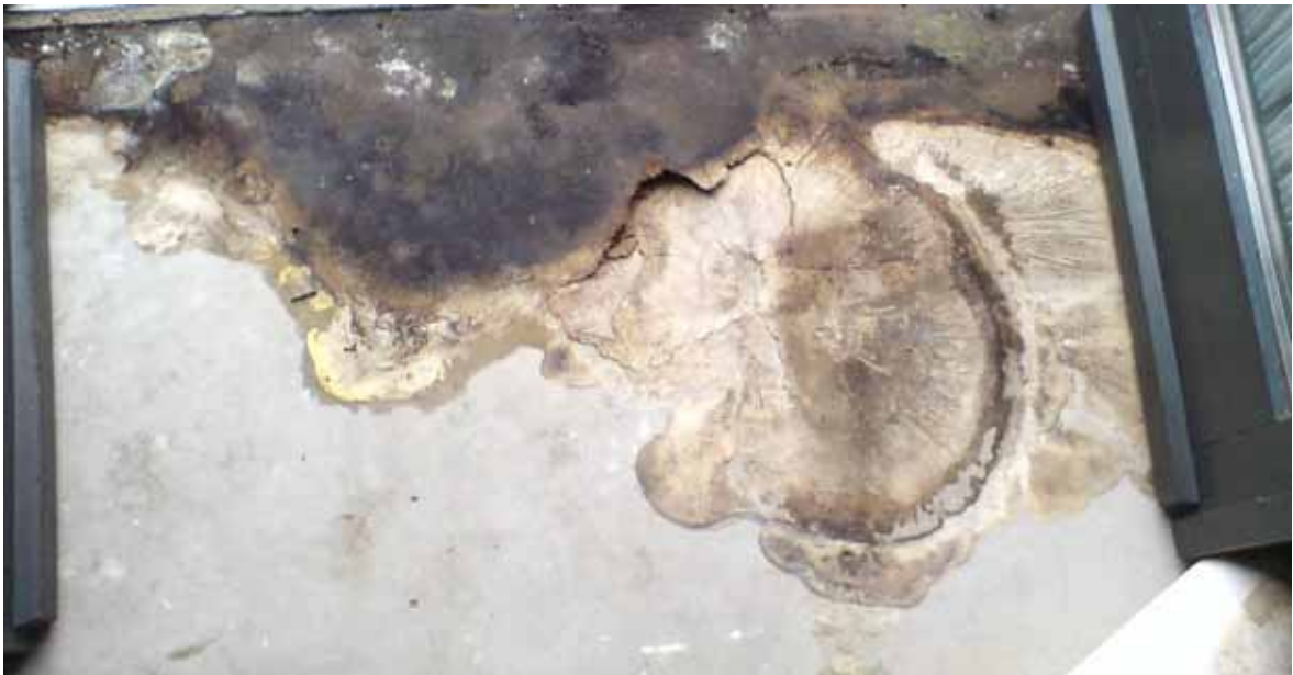
Abbildung 3-105 - Echter Hausschwamm auf Spanplattenboden unter PVC-Belag
