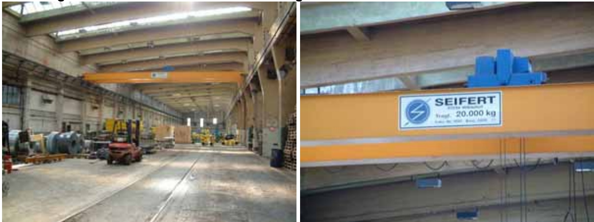
Abbildung 4-68 - Kranbahn mit einer zulässigen Hebelast von 20t
