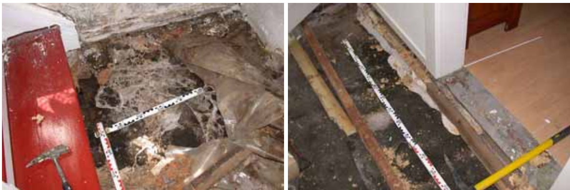
Abbildung 3-252 - Öffnen des Fußbodens vor der Treppe: Üppiges Strangmycel
