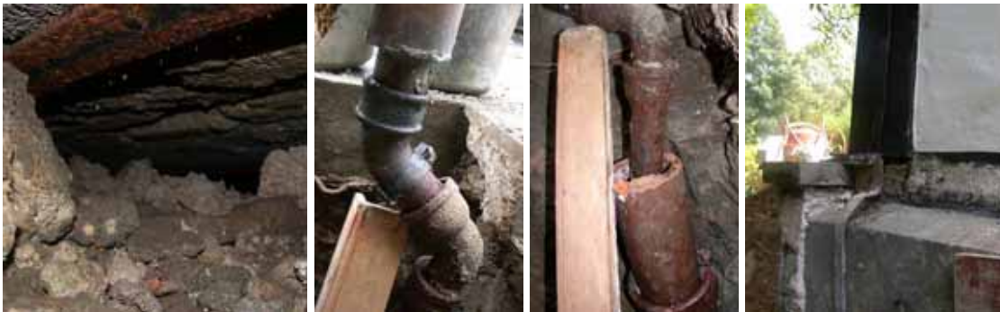
Abbildung 3-260 - Erdkontakt der Bimsdielen der Fußbodenkonstruktion
