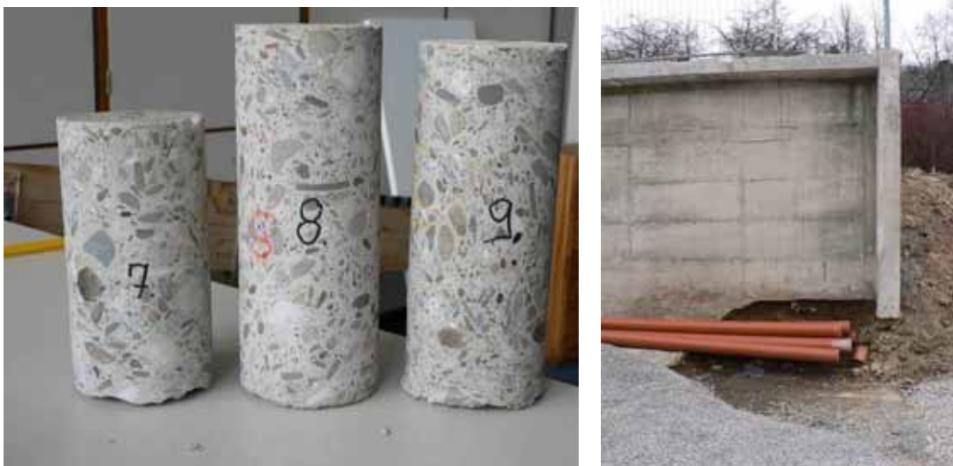
Abbildung 3-189 Bohrkerne Nr. 7-9 aus der Stützwand Abbildung 3-190 - Rechte untere Ecke der Wand ohne Fuß
