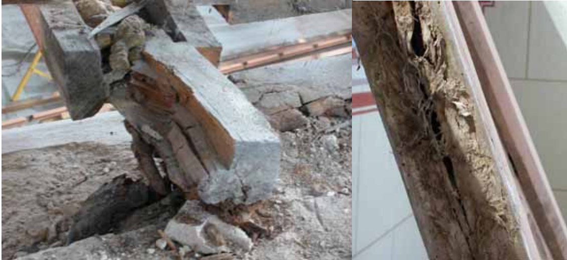
Abbildung 5-99 - Fußpunkt geschädigt durch Hausschwamm (Q.: K. Block)
