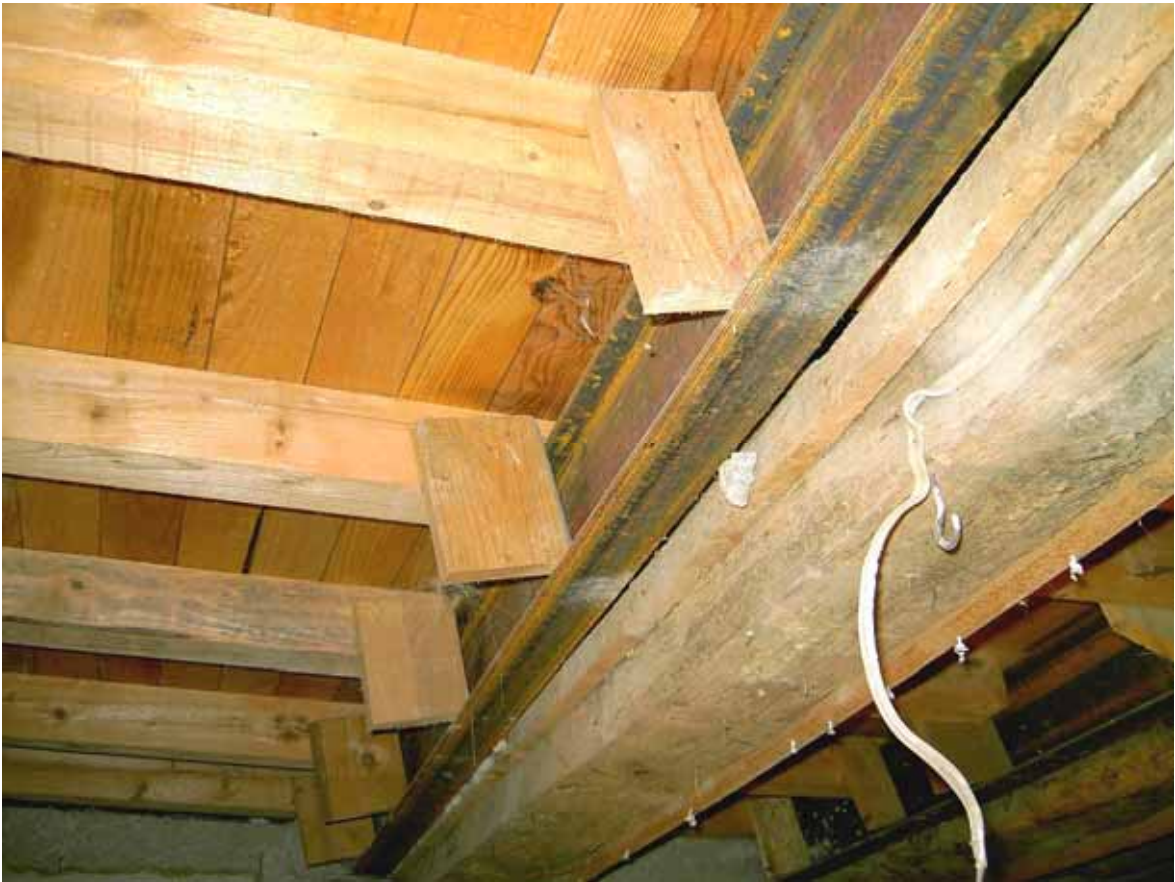
Abbildung 5-79 - „Ertüchtigung“ einer Holzbalkendecke durch Stahlträgern mit "besonderer" Ausbildung der Auflager der Streuhölzer
