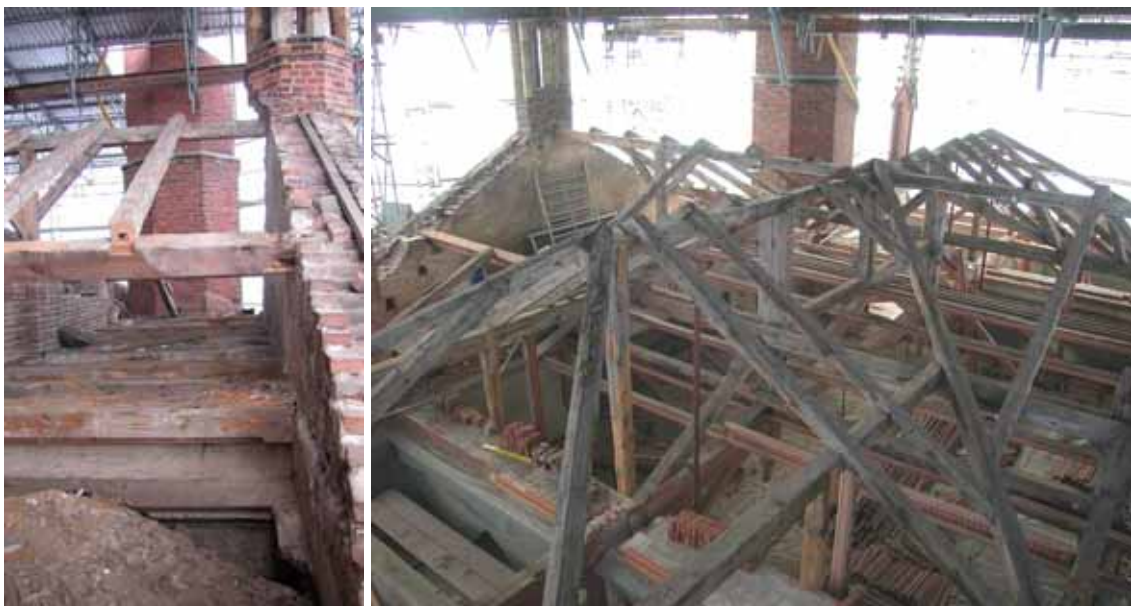
Abbildung 5-101 - Befallene Hölzer müssen großzügig abgeschnitten werden (Q.: K. Block)
