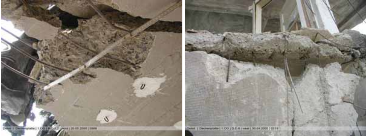
Abbildung 3-166 Abstand untere Bewehrung Deckenplatte Abbildung 3-167 - Deckenplatte mit erkennbarer unteren und oberen Bewehrung
