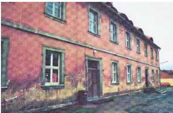
Abbildung 3-110 - Salzschiiden - Zonen unterschiedlichen Schadensgrades (Q.: Reul2005, S.112)
