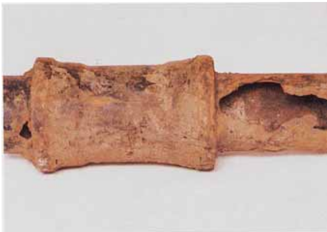
Abbildung 3-129 - Korrosion an einem Gussrohr (Q.: Nürnberger1995(a) , S.XI)
