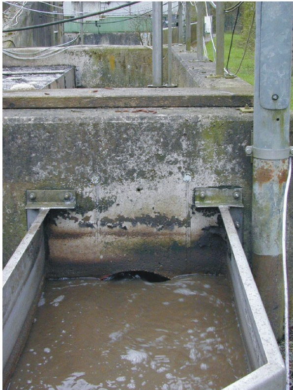
Bild 3.17: Hydraulischer Engpass zwischen Sammler und Zulauf zur NK
