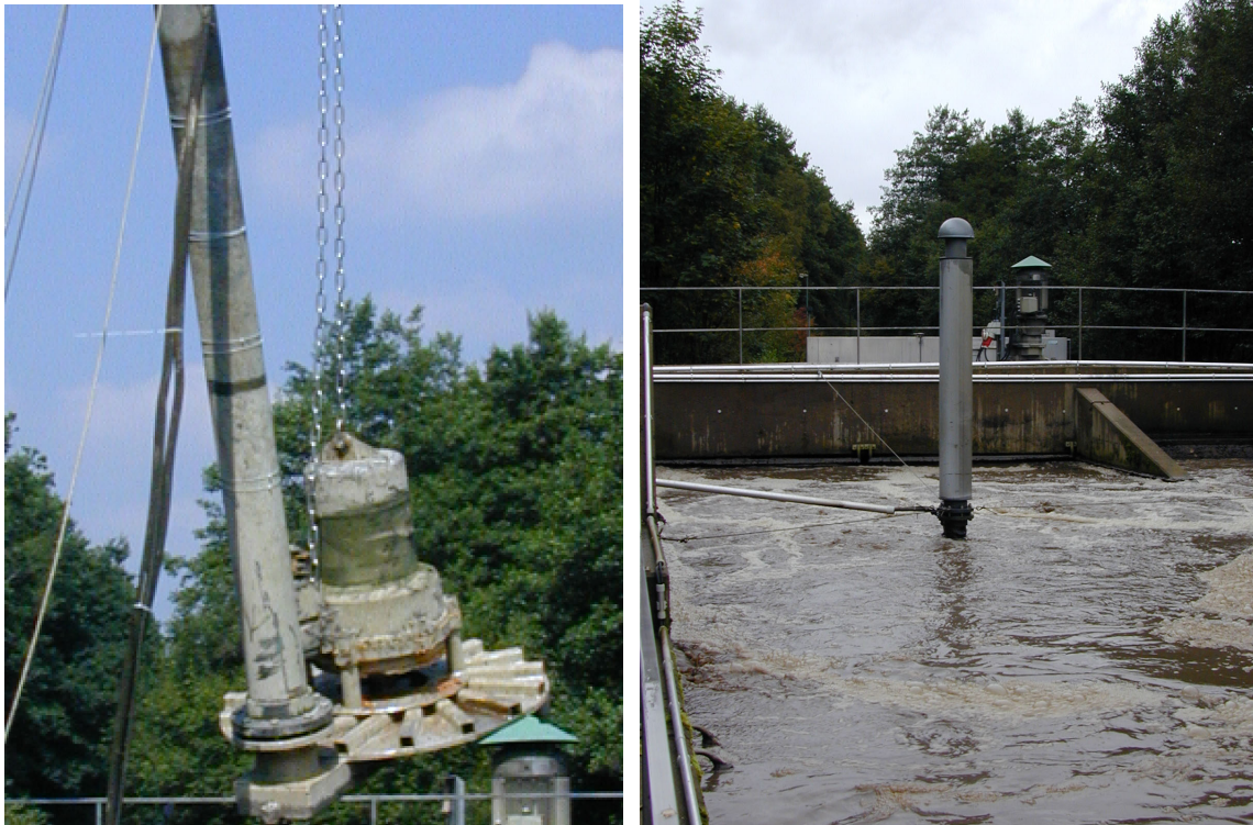
Bild 4.9: Im BB der Kläranlage Netphen eingesetzter Tauchbelüfter (links ausgebaut, rechts nach der Installation)
