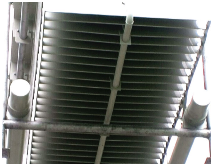
Bild 3.13: Druckluftrohr an einem Lamellenabscheider (aus /Scön00b/)
