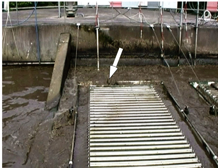
Bild 3.15: Zu geringer Abstand zwischen Lamellenabscheider und Kreisel 2 (aus /Scön00a/)
