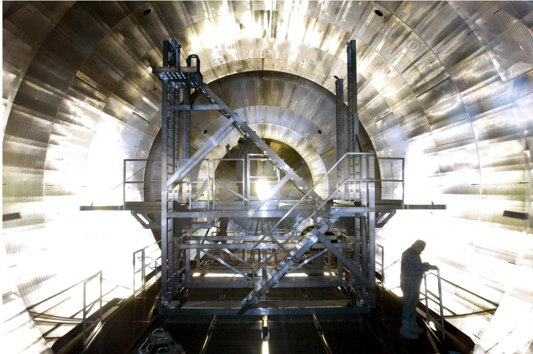
Abb. 4.50.: Die Plattform zur Installation der Module im Spektrometer. Die Plattform kann rotiert und sowohl vor und zurück als auch hoch und runter gefahren werden, um jeden Punkt im Spektrometer erreichen zu können. Von ihrer oberen Plattform werden die Module auf das Schienensystem gesetzt.
