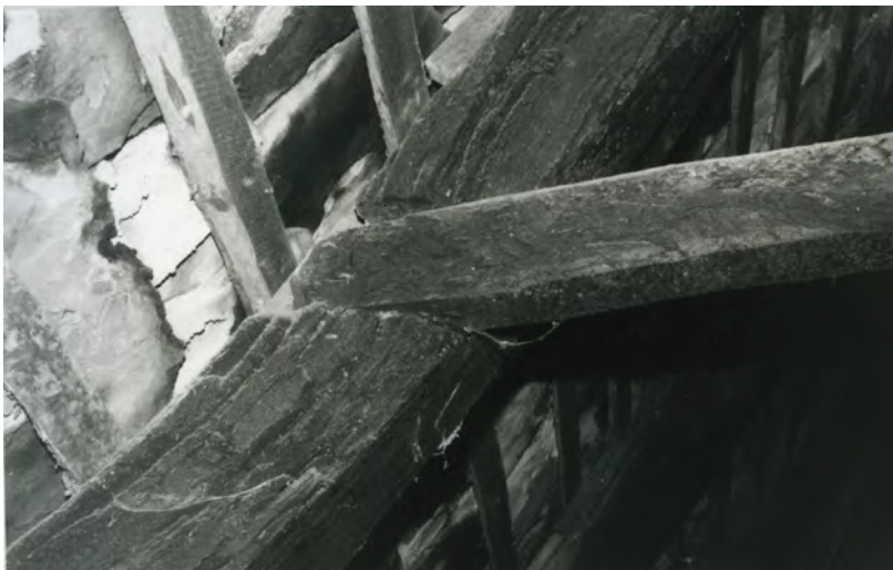
Bevern, Forster Str. 16, Dreistöckergebäude von 1555d, geblatteter Kehlbalken
