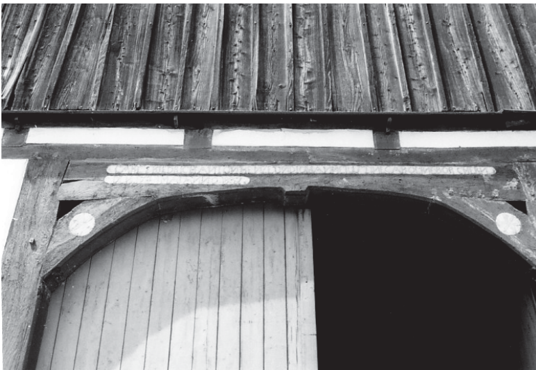
Warbsen, Forstbachtal 13, Scheune, Dielentorsturz
