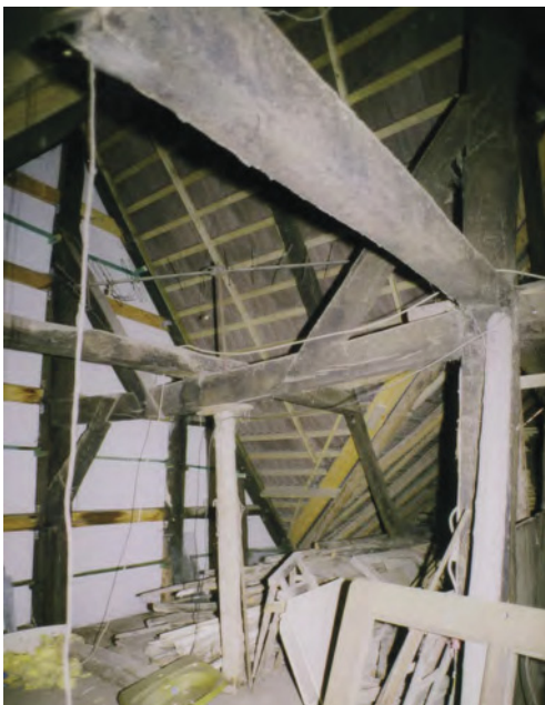
Rühle, Waldstraße 4, Spitzsäulendachwerk, W Giebel von Innen.
