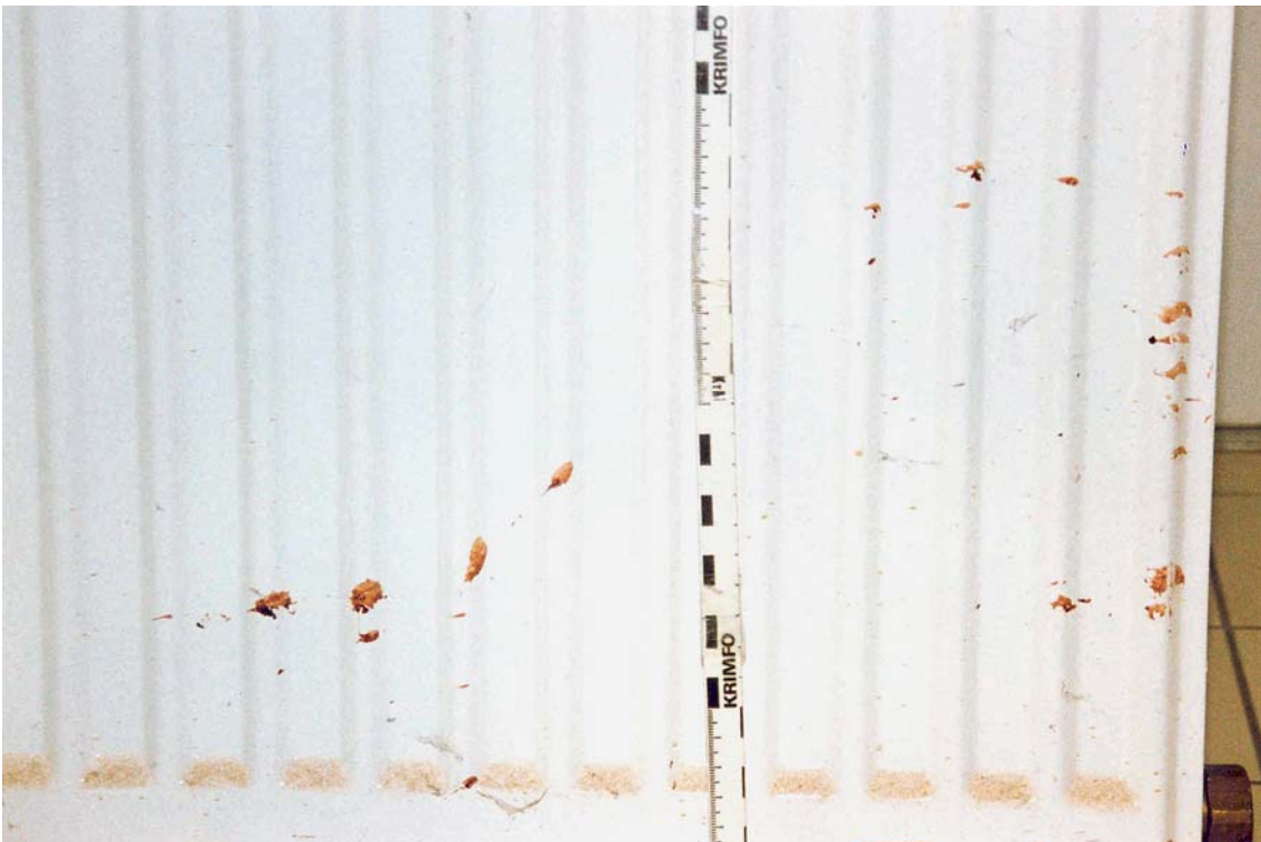
Abb. 67, Rückseite des Heizkörpers
