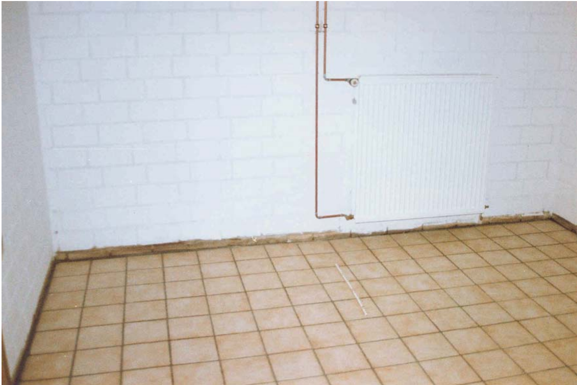
Abb. 65, Kellerraum mit Heizkörper
